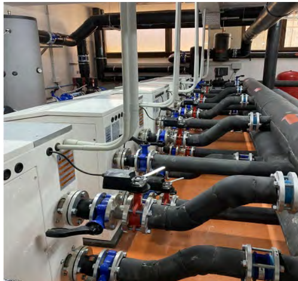
Ilustración 33. Sala técnica da instalación xeotérmica do Edificio de Ferro
