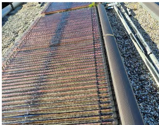
Ilustración 35. Instalación solar térmica con tubos de baleiro na Ecimat
