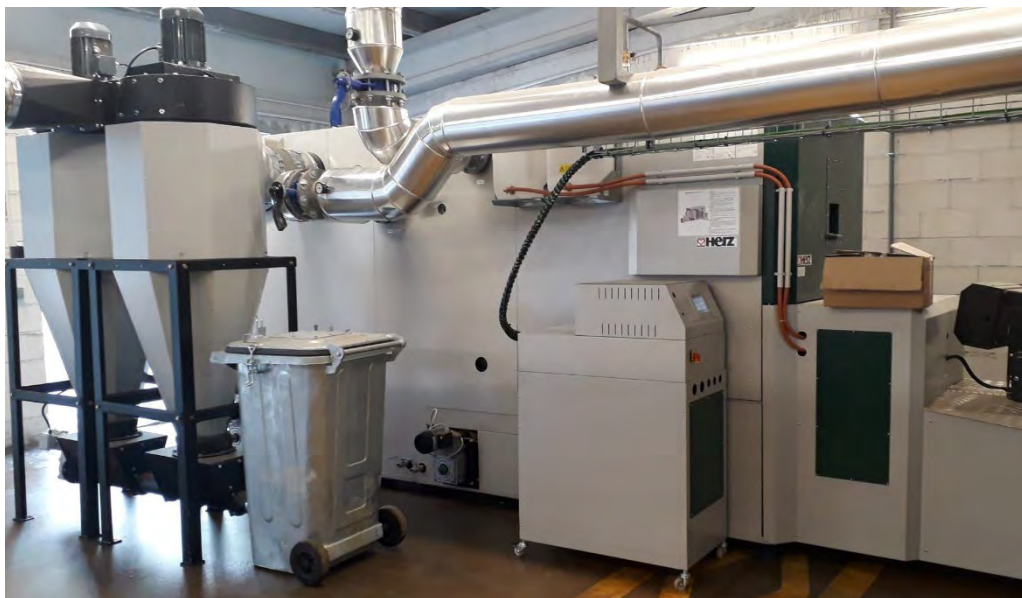
Ilustración 32. Caldeira de biomasa da instalación de district heating
